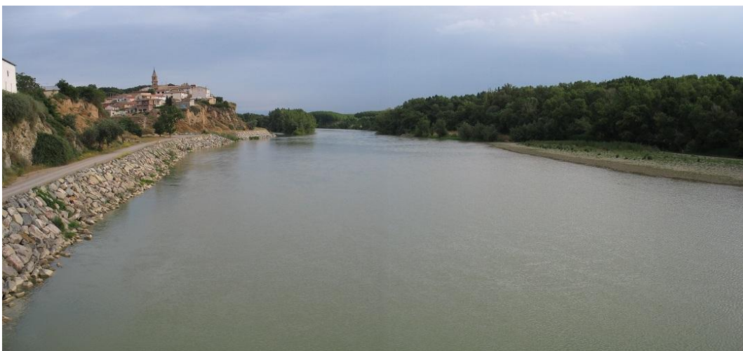
Figura 15-11. Defensa de margen en la localidad de Milagro.
