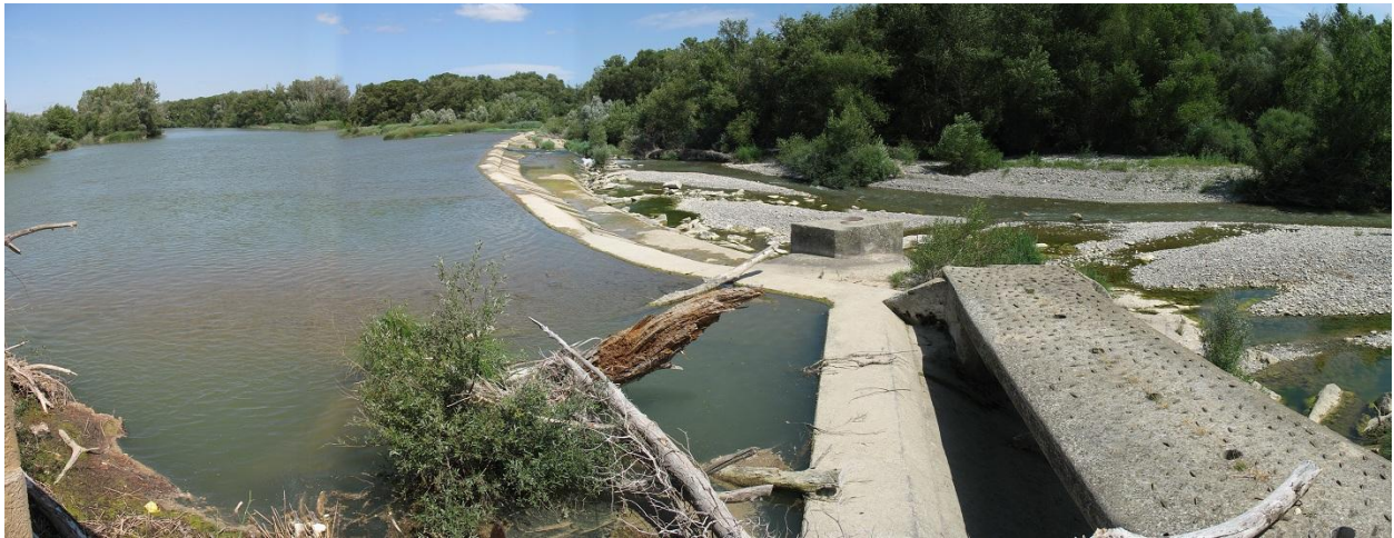
Figura 15-4. Azud de Santacara: represamiento y afecciones aguas abajo.
