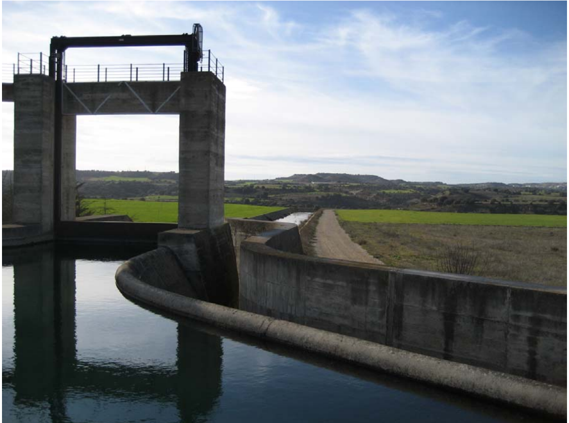
Ref. 33.- Detalle de un aliviadero y desagüe del Canal del Cinca hacia el río Alcanadre que se utiliza por mantenimiento del canal o en caso de fuertes tormentas.
