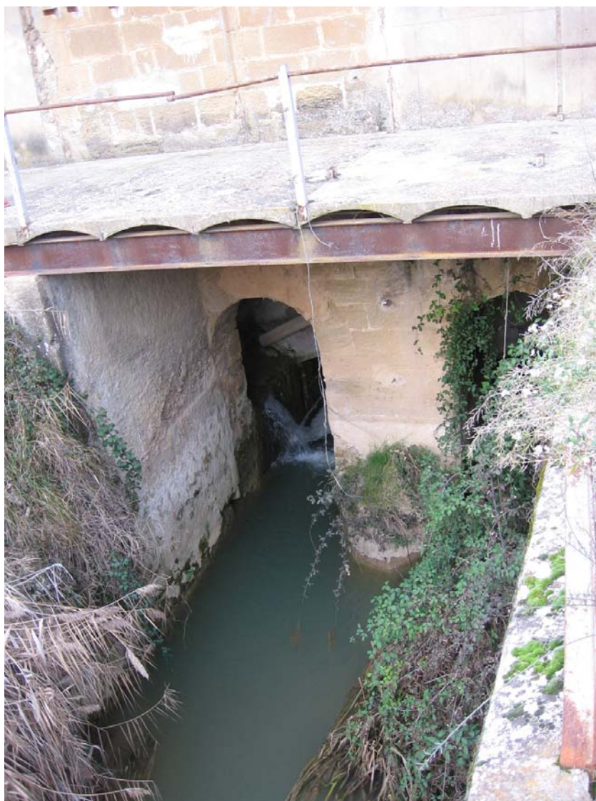
Ref. 41.- Minicentral hidroeléctrica de Huerto: salida de agua.
