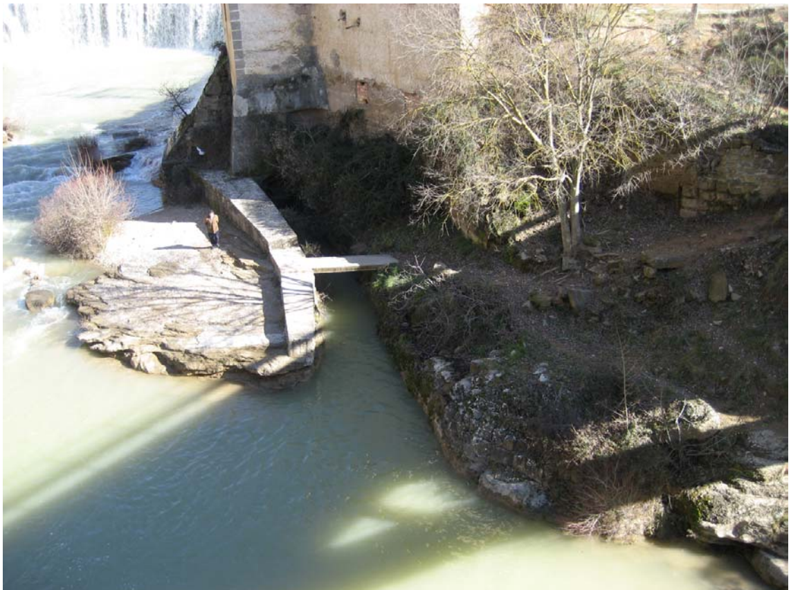
Ref. 14.- CH de Bierge: salida de agua a la CH.
