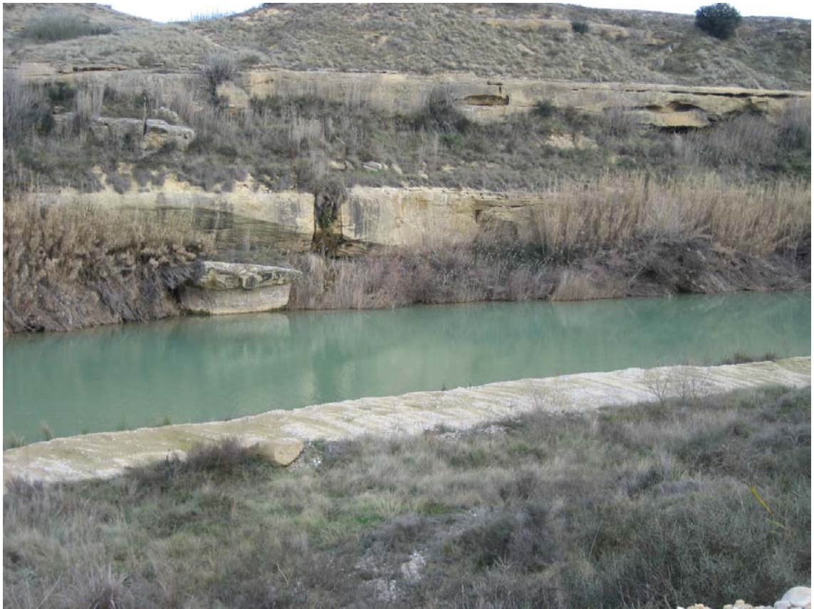
Ref. 39.- Vista del mal estado de la ribera en la margen derecha del río Alcanadre aguas abajo del azud de la minicentral hidroeléctrica de Huerto debido a una antigua extracción de gravas allí realizada.
