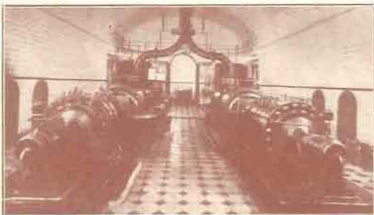
INSTALACIÓN DE LA MINA "ABRAYANES" (AÉN) CUATRO GRUPOS DE BOMBAS 11 litros por segundo, 325 metros altura elevación, 300 HP. cada grupo. Instalación de bombas centrífugas más importante de España.
