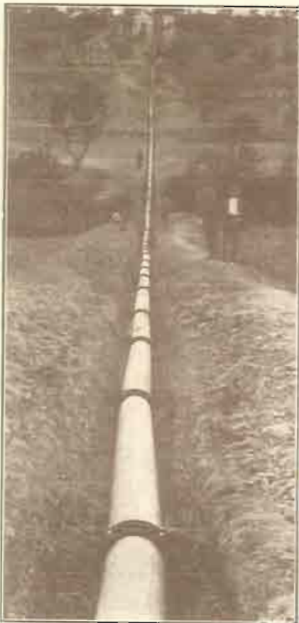
CONDUCCIÓN DE AGUAS EN CERVERA (Lérida). 1065 metros longitud. - 250 mm diámetro. - 10 almóferas.
