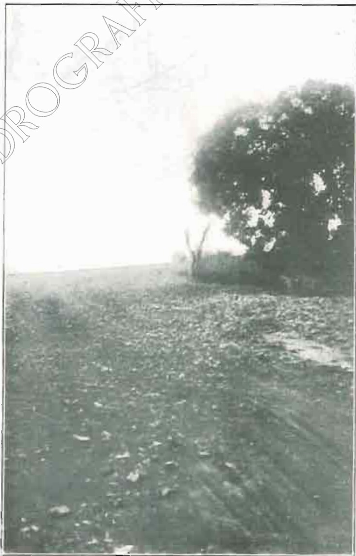
Un badén de la carretera entre Bágüena y Luco, ocupado por los materiales arrastrados por la rambla.
