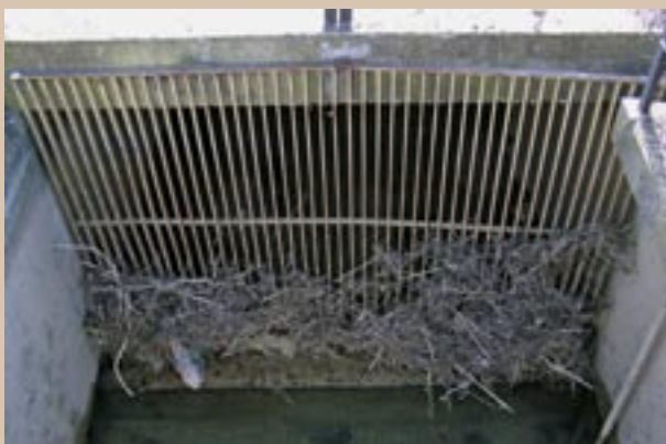
Reja entrada estación de bombeo.
