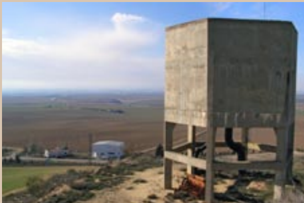
Estación de bombeo de elevación y depósito.
